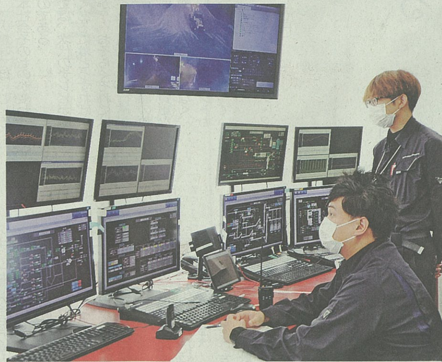
発電所の運転状況を24時間体制で見守るUREの中央操作室
